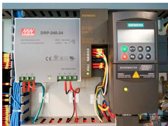
6. Verificar el encendido de las fuentes de alimentación y el variador de velocidad
