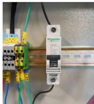
2. Encender el totalizador del medidor de energía
