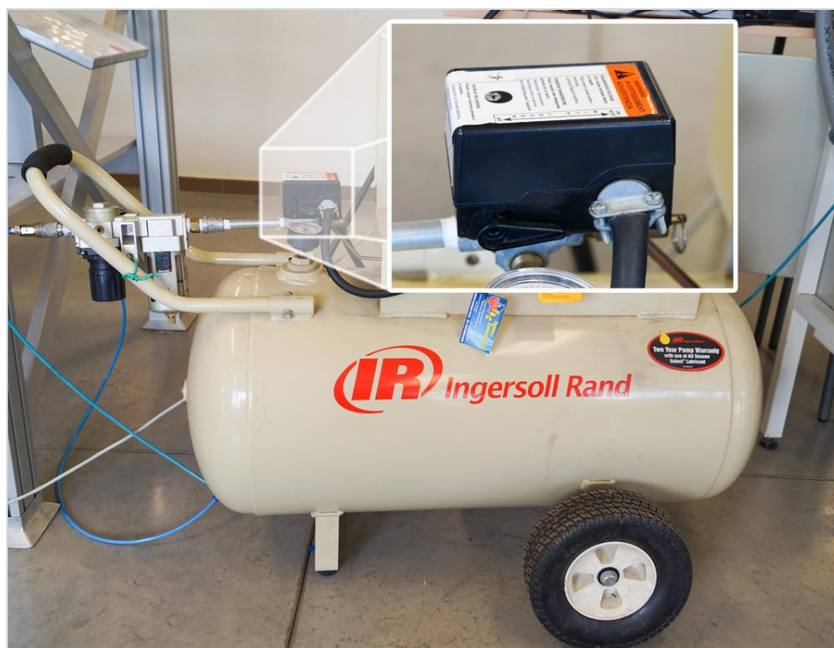
Figura 57. Encendido del compresor
