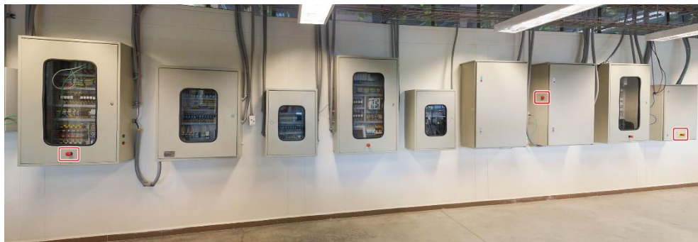
Paradas de emergencia del nivel de control
