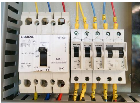
1. Encender el totalizador principal y luego los totalizadores secundarios
