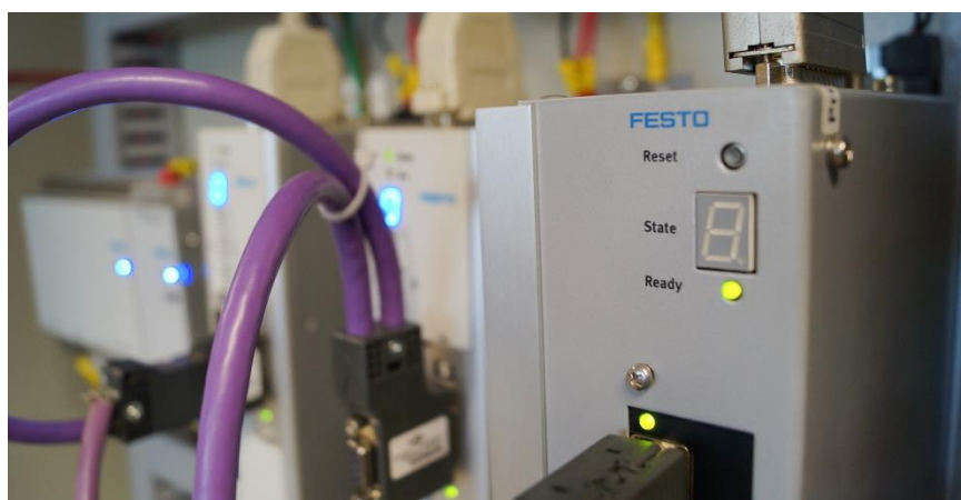
4. Verificar el encendido de las fuentes de alimentación de los controladores del cartesiano. Si el encendido es correcto los controladores del eje X y Y deberán parpadear en secuencia P-0-0-0 y el indicador Ready del controlador Z debe encenderse.
